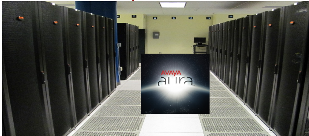
UW Data Center
